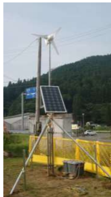
写真—4 田人地区の太陽光・風力施設
